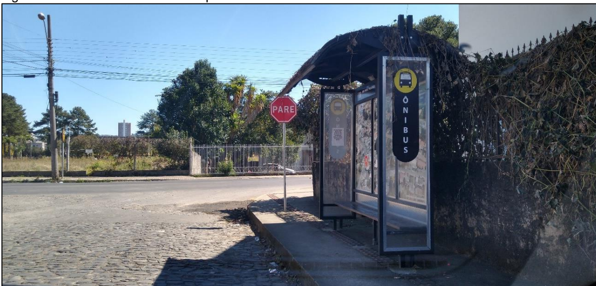
Figura 118 – Ponto de ônibus com piso tátil executado incorretamente
